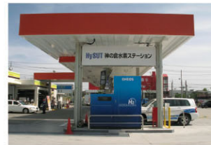
神の倉 (オンサイト型 70MPa) Kaminokura (On-site)
